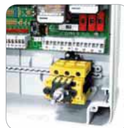
Particolare del sezionatore
