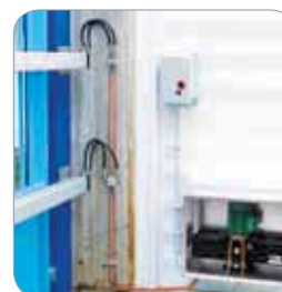
Centralina idraulica MEC 700/80 VENTIL con doppio serbatoio all'interno dell'armadio di protezione
